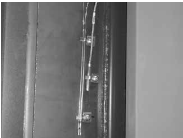
Abb. 15 - Ansicht des Abgastemperaturfühlers TSV an der Seite des Rauchkanals des Kessels DCxxGSP
