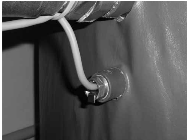
Abb. 14 - Ansicht auf Wassertemperaturfühler im Schutzrohr des Akkumulationsbehälters (TV und TS)
