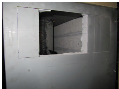
(Beispielhafter Dämmhauben Ausbruch)
