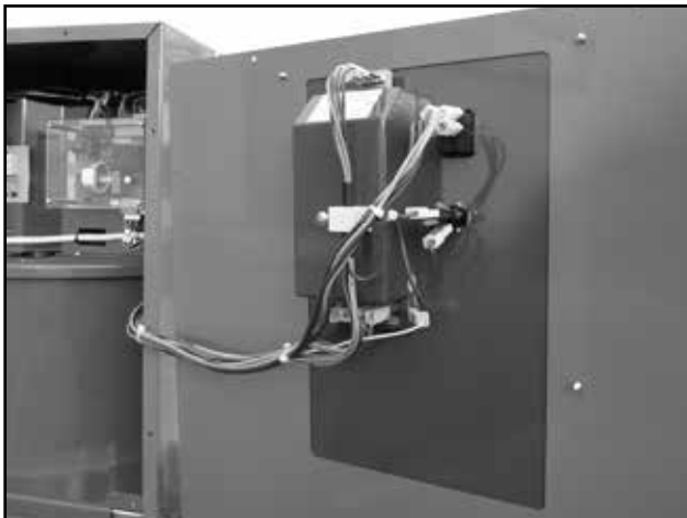
Elektronische Regeleinheit AC19 auf der Frontplatte der Anlage
