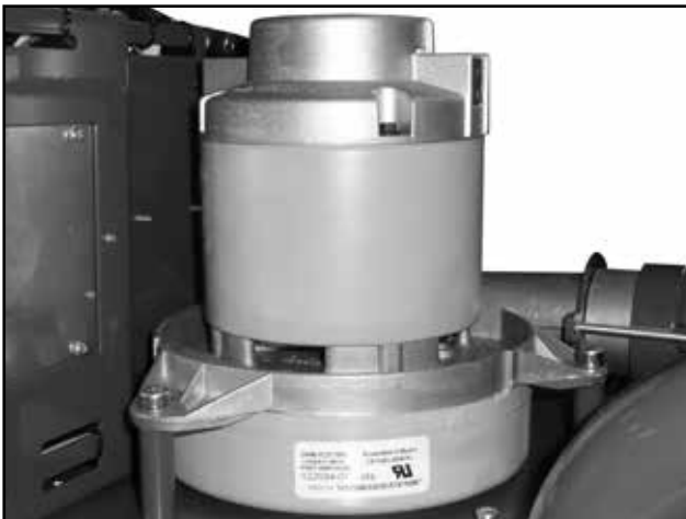
Motor des Sauglüfters der pneumatischen Förderanlage
