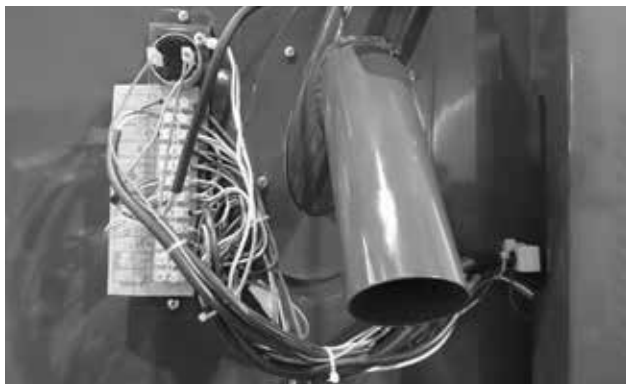
Elektroinstallation des Kessels unter dem vorderen Gehäuse
