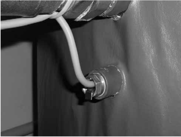
Abb. 13 - Ansicht auf Wassertemperaturfühler im Schutzrohr des Pufferspeichers (TV und TS)
