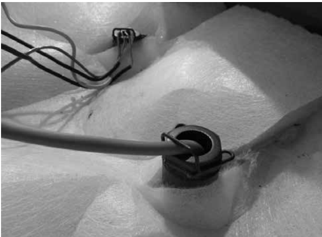
Abb. 15 - Ansicht des Wassertemperaturfühlers TK im Schutzrohr des Kessels DxxP, Pxx
