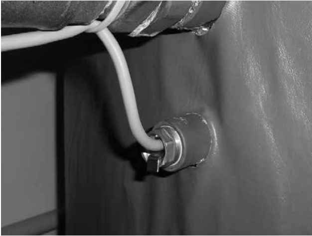
Abb. 13 - Ansicht auf Wassertemperaturfühler im Schutzrohr des Akkumulationsbehälters (TV und TS)
