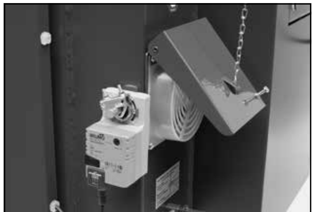
Die Klappe für die Verbrennungsluftzufuhr in den Kessel geöffnet (eingestellt)
