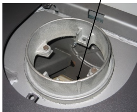
Markierung für den Kondensatablauf.
