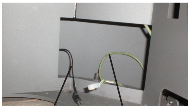
Câble alimentation électrique Câble de sonde
