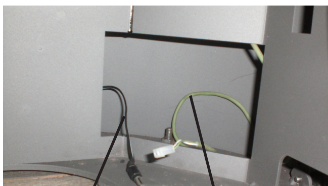
Bekabeling stroomvoorziening Sensorkabel
