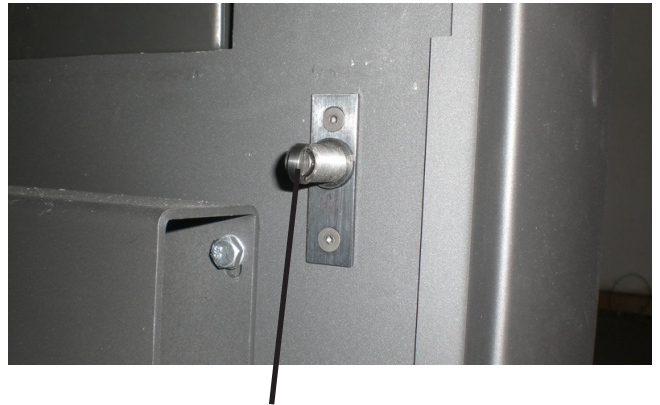
Door contact switch
